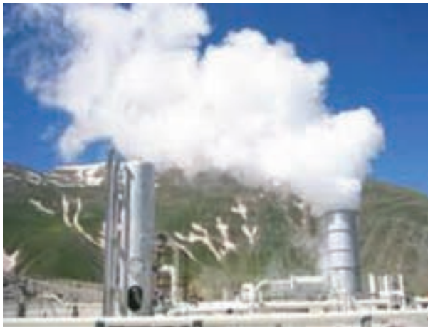
شکل ۱-۸- نیروگاه زمین گرمایی مشکین‌شهر - اردبیل
